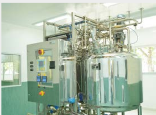
Foto 2. Sala productiva de medicamentos fármacos inyectables
